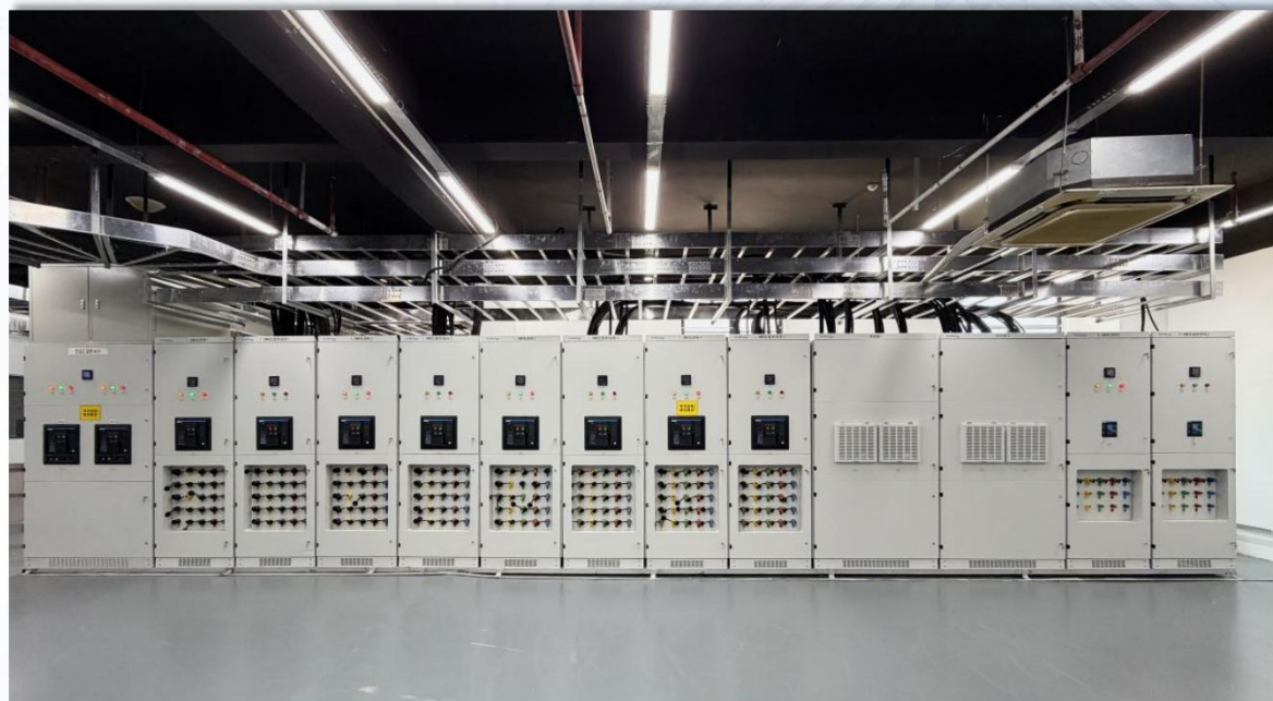
4.5MW大功率测试平台
