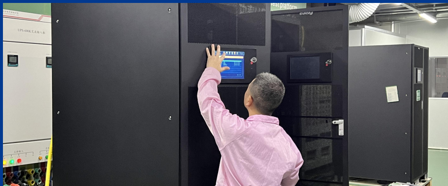
大功率UPS测试
