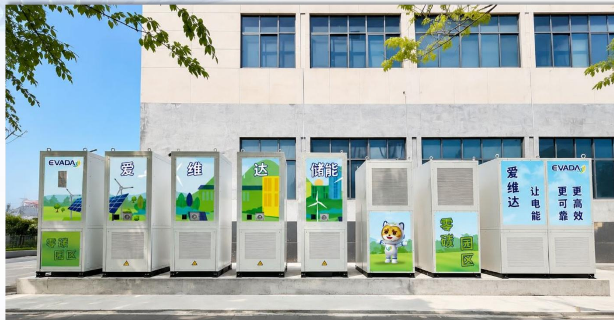
1MW/2MWh储能平台
